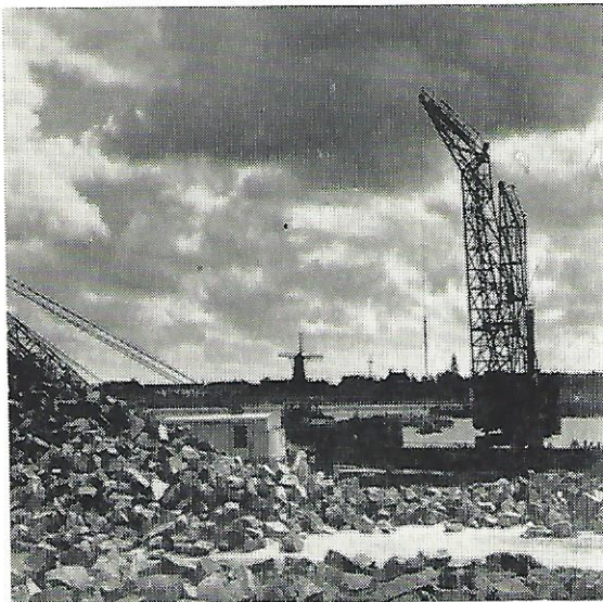
Een stapel basalthokken, benodigd om de zinkstukken te verzwaren, ligt in de werkhaven te wachten op verscheping.
